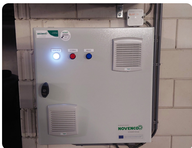
Steuerschrank mit Frequenzumrichtern und SPS-Steuerung
