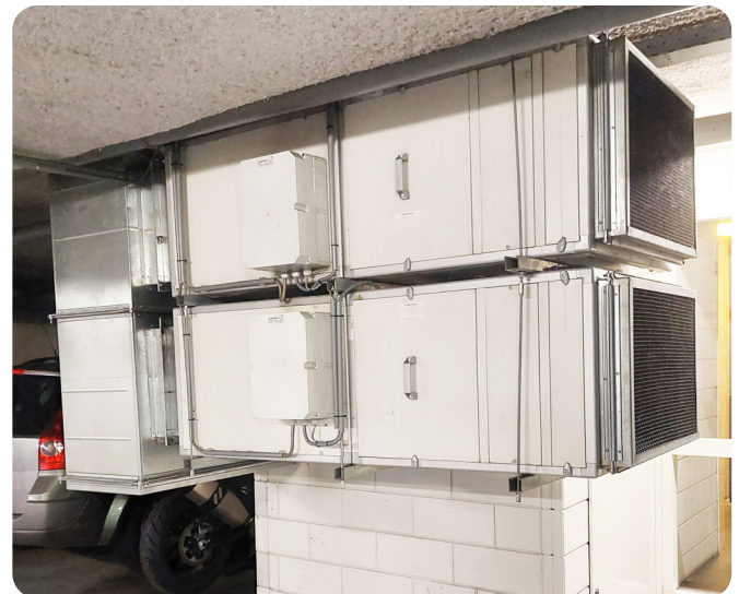
Das alte Belüftungssystem mit Radialventilatoren
