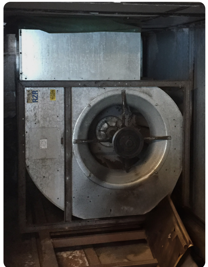
Before retrofit- centrifugal fan
