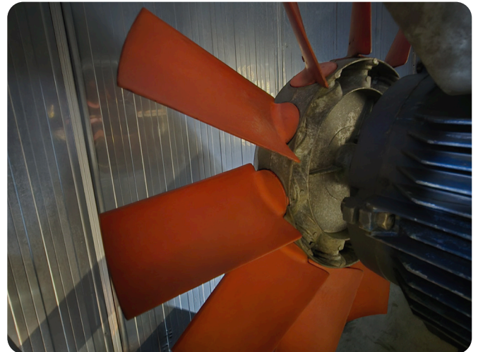
Alte Ventilatoren – ineffizient und veraltet
