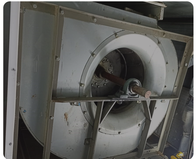
Veralteter Radialventilator vor der Modernisierung
