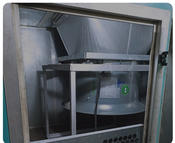
ZerAx-Axialventilator in Aktion – ersetzt den veralteten Ventilator
