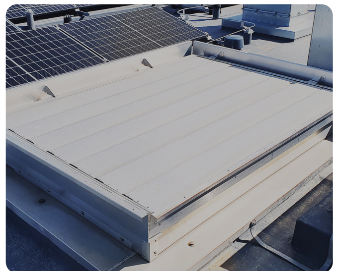
EN 12101-2-konforme Treppenhause-Abbluftanlage (AOV)
