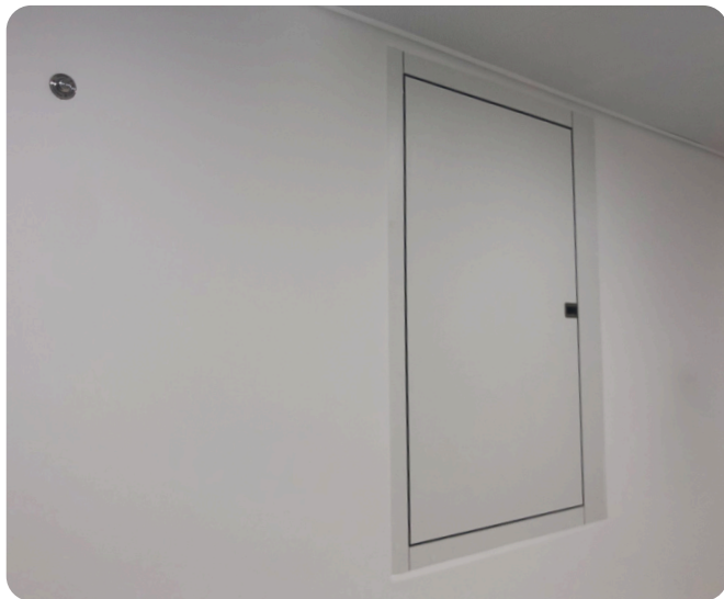
Rauchzugklappe im Flur installiert – Gewährleistet sichere und effiziente Rauchabführung in Notfällen
