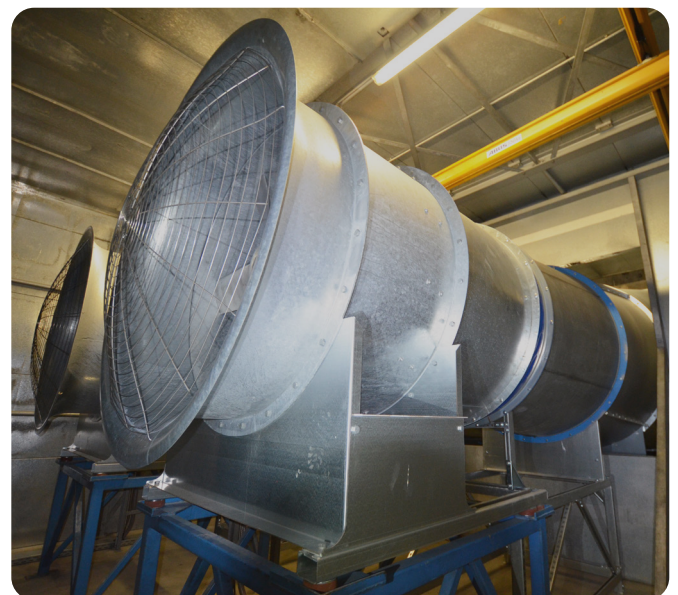
Neu installierte ZerAx®-Axialventilatoren mit wiederverwendeten Halterungen und Diffusoren für minimalen Materialeinsatz.
