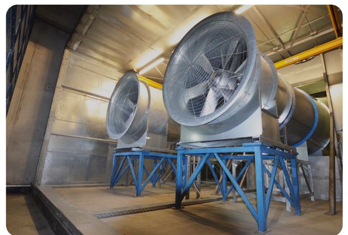
ZerAx ® -Lüfter im Einsatz, die das veraltete System ersetzen
