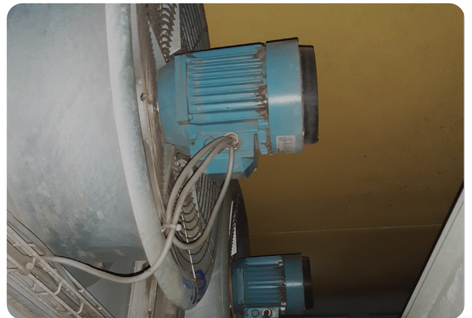
Veraltete Lüfter bei Zott vor der Modernisierung
