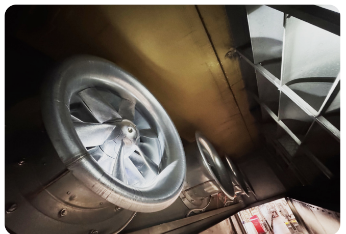
ZerAx®-Ventilatoren wurden nach der Nachrüstung bei Zott installiert
