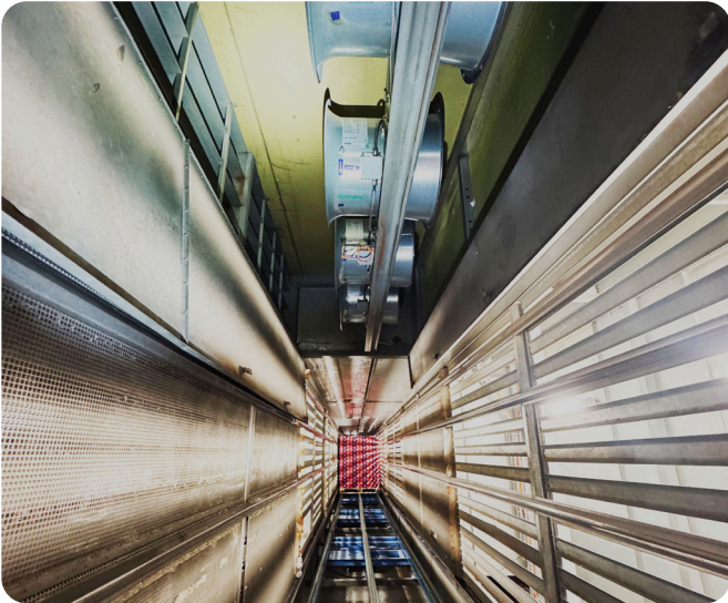
ZerAx®-Lüfter sind für zuverlässige Leistung im Kühltunnel installiert.
