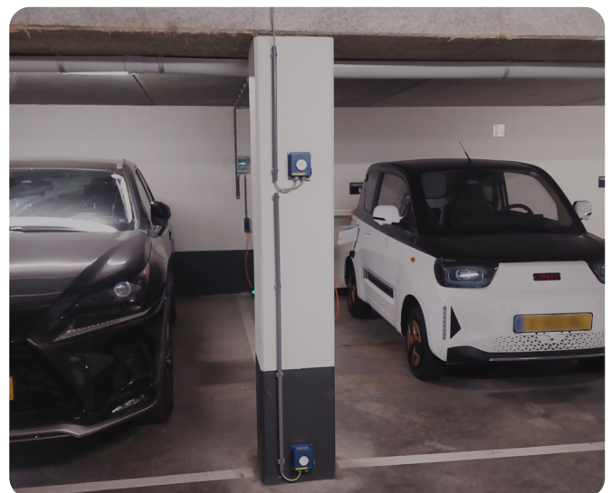
CO-/LPG-Überwachungssystem für kontinuierliche Kontrolle und Sicherheit
