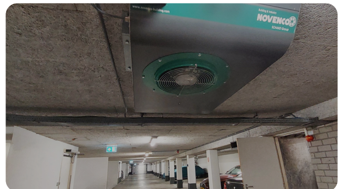
Jet-ventilatoren direct aan het plafond gemonteerd voor ruimtebesparing.
