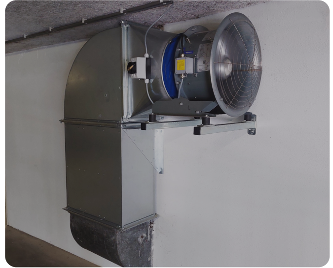
Nadien: moderne straalventilatoroplossing – betrouwbaar en energiezuinig
