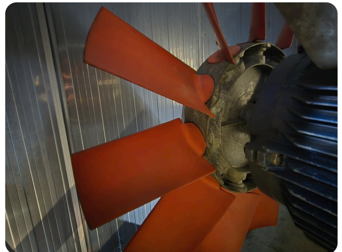
Oude ventilatoren – inefficiënt en verouderd
