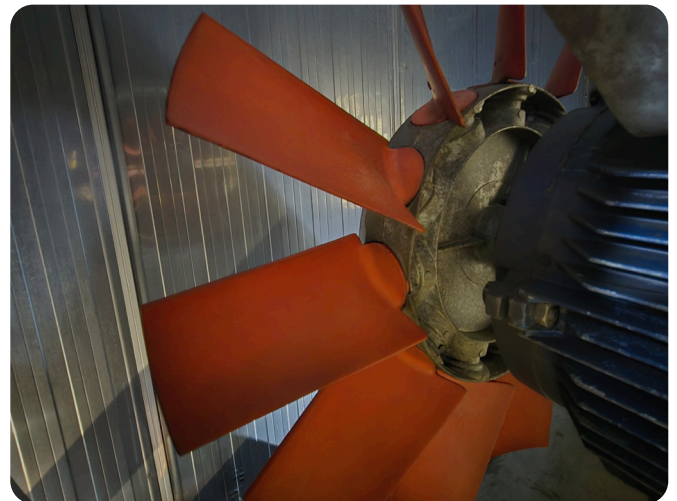
Udtjente ventilatorer – ineffektive og forældede
