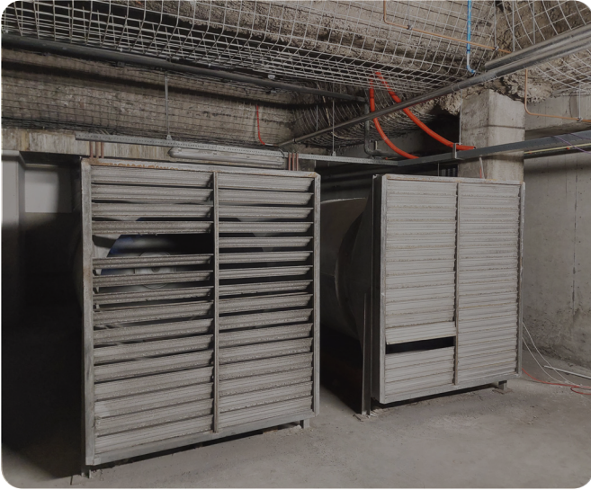
Pre-installatie: Twee versleten ventilatoren die jaren van intensief gebruik weerspiegelen
