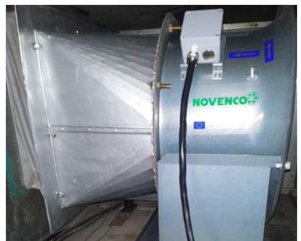
Einer von 40 NOVENCO ZerAx EC+-Ventilatoren, mit einfacher Plug-and-Play-Nachrüstung
