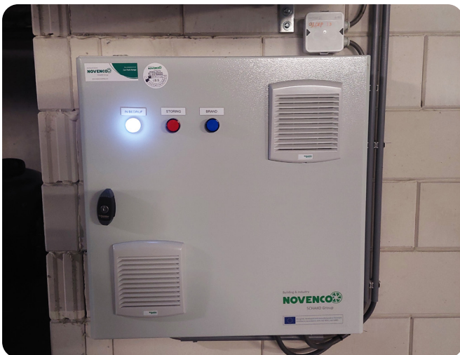
Besturingskast met frequentieomvormers en PLC-besturing
