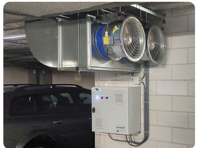
Het nieuwe ventilatiesysteem met ruimtebesparende ZerAx-ventilatoren.
