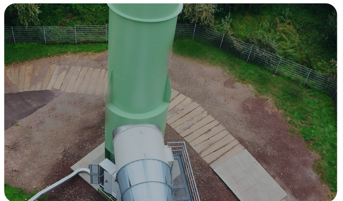
Ansicht des neuen Belüftungssystems von oben
