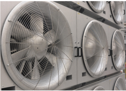
DATA CENTRE, SKANDINAVIEN
