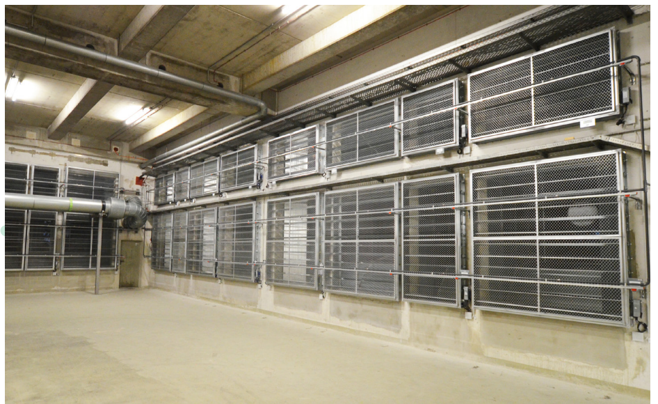
Ausblaskammer mit Jalousieklappen. Dank der Kanäle wird die Strömungsgeschwindigkeit bis zu den Klappen aufrecht erhalten und dadurch keine Energie mehr verschwendet.
