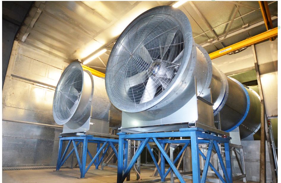
ZerAx® AZN-1600 mit bis zu 92 % Wirkungsgrad nahezu über den gesamten Regelbereich. Wesentliche Teile wie Konsolen und Diffusoren der Bestandsventilatoren konnten wieder verwendet werden. Dadurch wurde minimaler Materialeinsatz gewährleistet.
